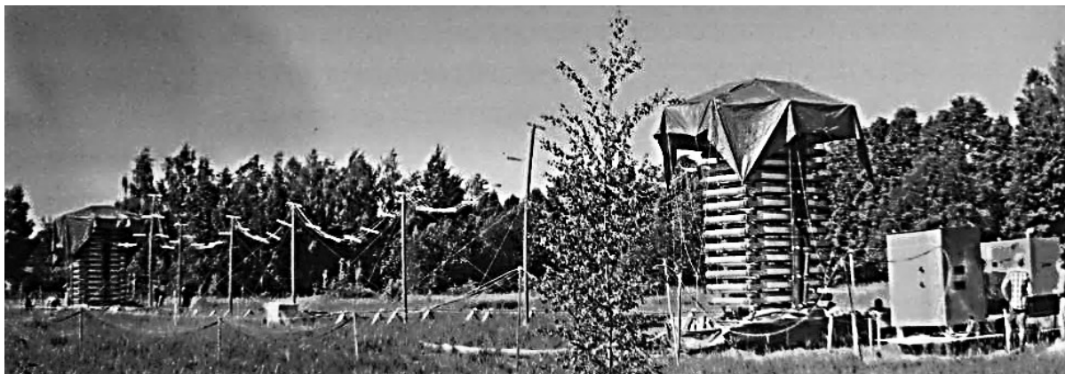
Рис. 6. Фотография ГИН на месте испытания (г. Троицк)
