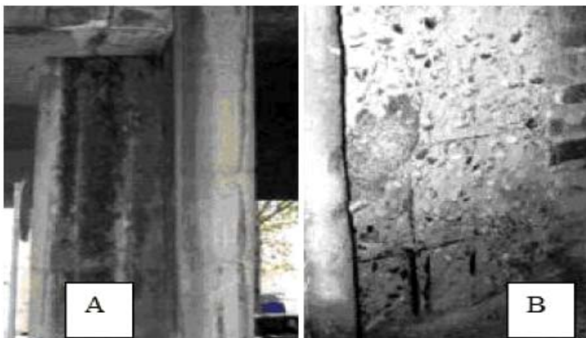
Рис. 2. Примеры повреждений материалов здания: А – биоповреждение опоры; В – биоразрушение основания здания грунтовыми водами
