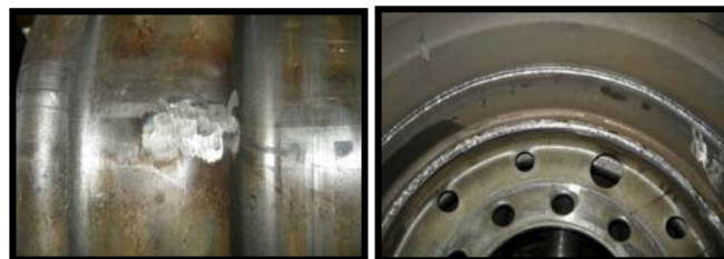
Нарушение поверхности основного металла при зачистке сварного шва обода.
