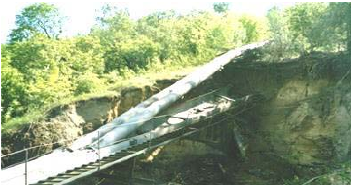
Рис. 1. Оползень на участке восточного спуска трассы ГЗУ ТЭЦ-2. Разрушен железный лоток, деформация рабочих ниток золопровода.
