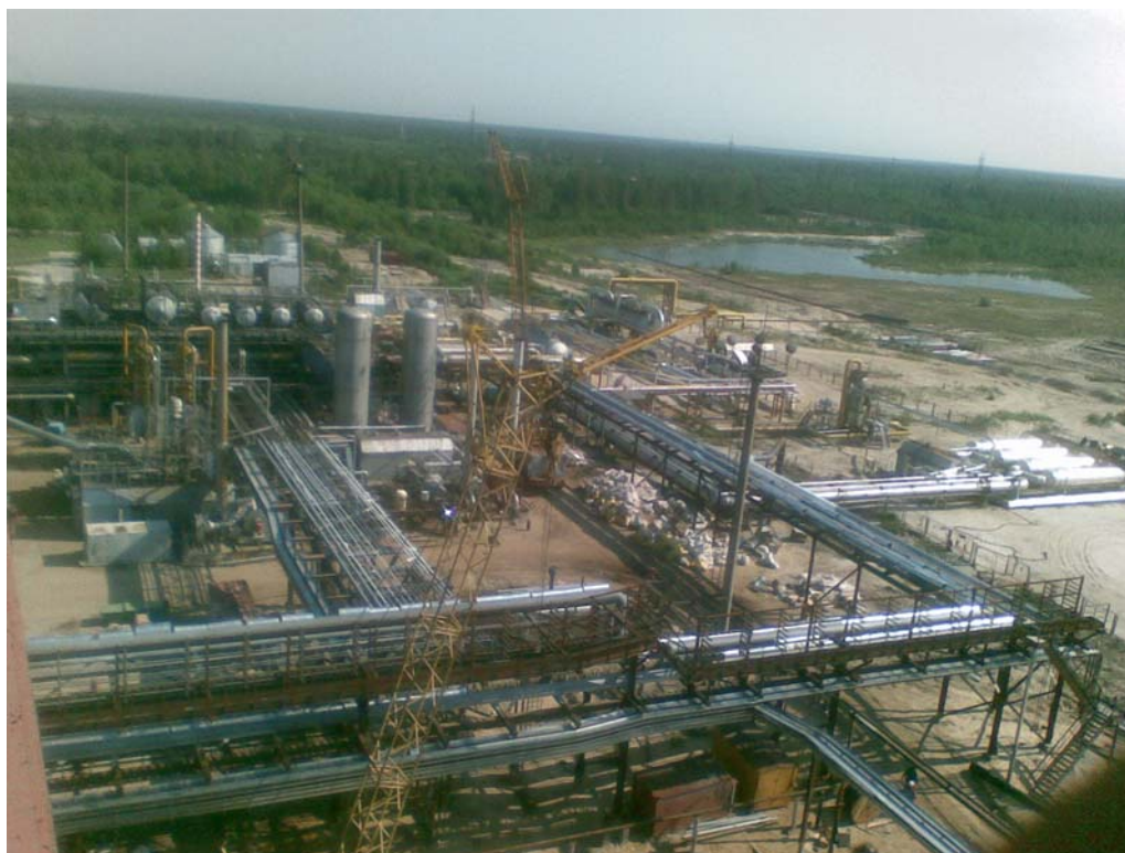
Рис.1 Компрессорная станция ( г. Ноябрьск, 2009 год).
